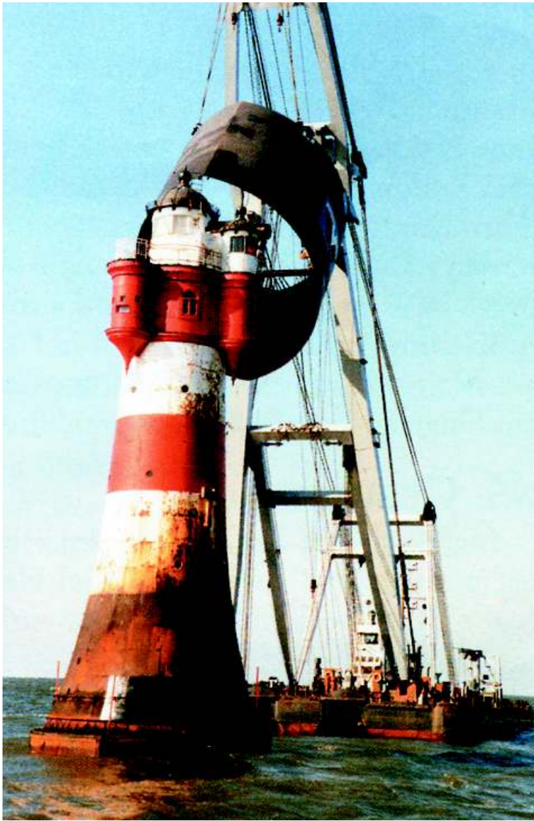
Abb. 1: Ein 1983 gegründeter Förderverein konnte den Abbruch des Denkmals verhindern. Und so wurde 1987 eine weitere Meisterleistung fällig. Eine etwa 100 t schwere Stahlmanschette wurde von oben über den Turm auf den Meeresboden abgesenkt Foto: Deutsche Stiftung Denkmalschutz
